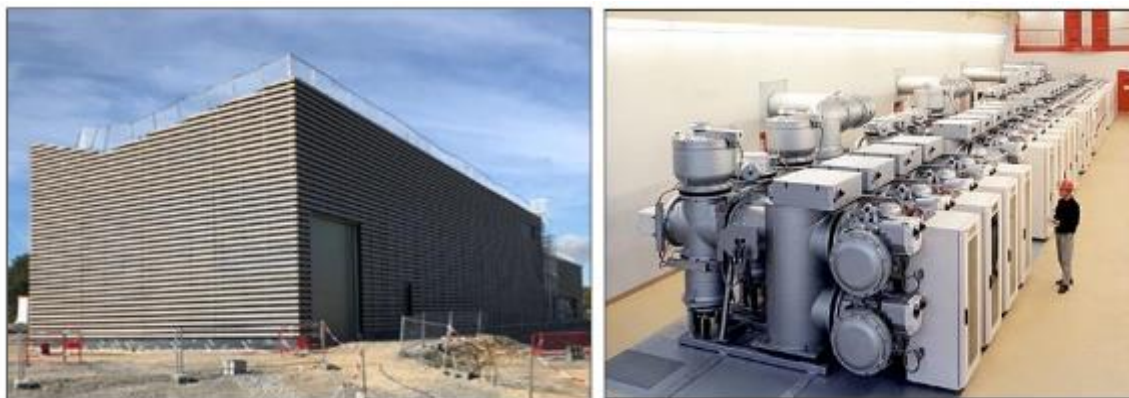
Figure 5 : Exemple de poste sous enveloppe métallique (source : RTE)
