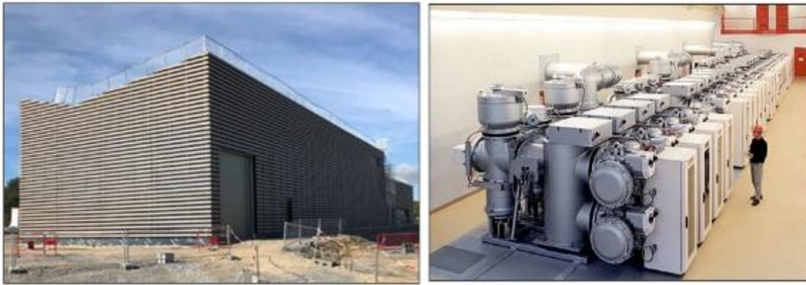
Figure 6 : Exemple de poste sous enveloppe métallique (source : RTE)
